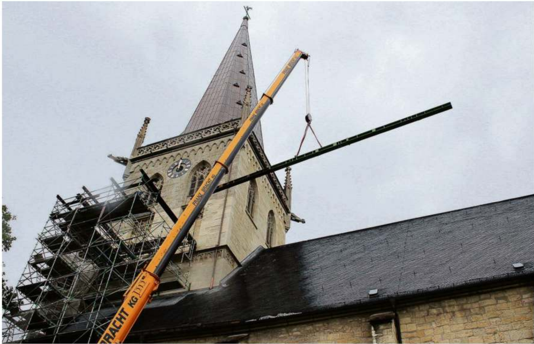
Mehr als drei Tonnen schwer ist ein Stahlträger, der vom Gerüst in 30 Metern Höhe auf den Boden transportiert wurde.
