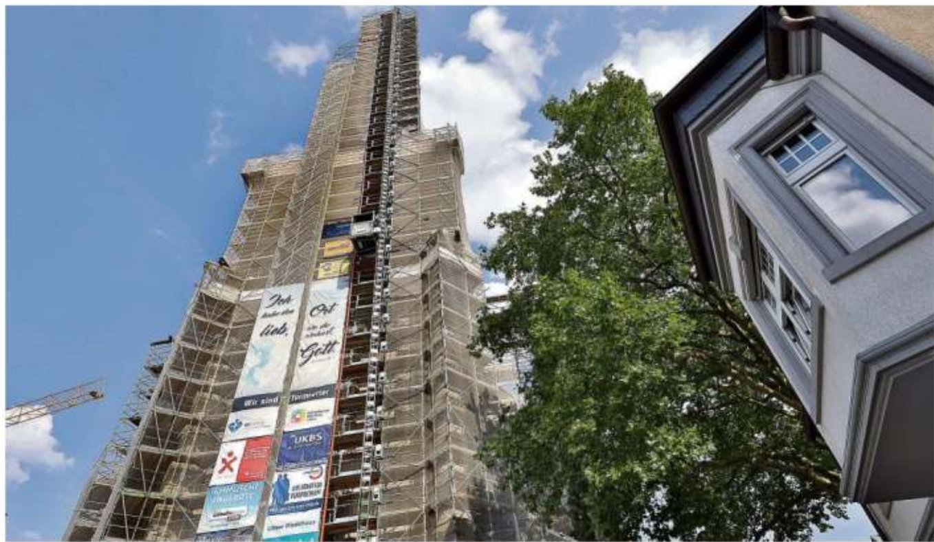
Das Gerüst an der Turmspitze ist bald nicht mehr zu sehen: Mitte September soll der Turmhelm der Evangelischen Stadtkirche wieder sichtbar sein. Das Geld für die vollständige Sanierung fehlt jedoch weiterhin.
