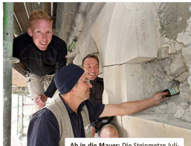
Ab in die Mauer: Die Steinmetze Julian Wally (l.), Heinz Hörger (vorne) und Polier Thomas Salinger lassen die neue Flaschenpost in der Stadtkirche verschwinden.
