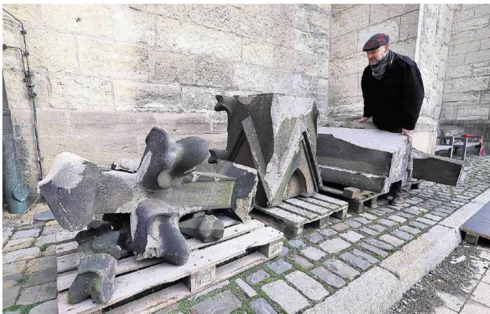
Die Reste der Fiale, die im Januar 2018 im Turm der Stadtkirche gestürzt war. Nach der Vermessung für eine Rekonstruktion hat sie für die eigentliche Sanierung der Kirche keine Bedeutung mehr. Die Gemeinde will sie aber für eine Dokumentation des Sturmereignisses und der großen Rettungsaktion für die Stadtkirche verwenden. FOTO DRAWE
