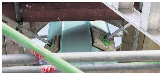
Das Baugerüst ist an das Turmdach bloß angelehnt, nicht verschraubt, wie dieses Bild aus etwa 75 Metern Höhe zeigt.
