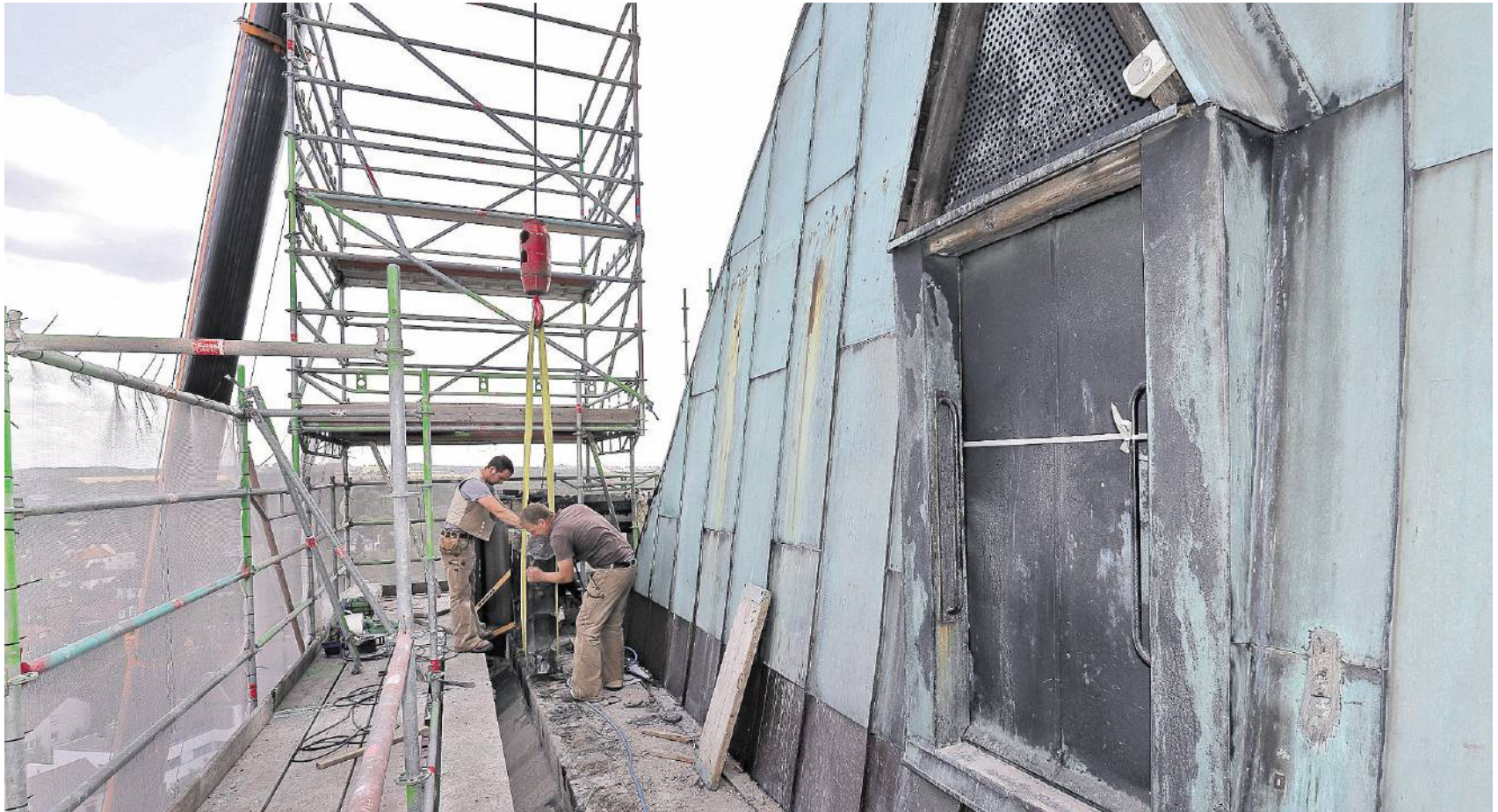
Auch die grünliche Kupfereindeckung des Turmdachs ist marode. Das Dach muss komplett neu eingedeckt werden. Das Bild entstand während der Steinmetzarbeiten auf der Balustrade, als das Dach noch nicht eingerüstet war.
