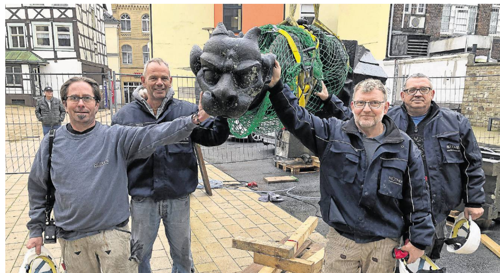
Einen der „Höllenhunde“ hatten die Arbeiter der Fachfirma Nüthen ausgebaut, um sich ein Bild vom Zustand und der Bauart der zuvor nicht sichtbaren Verankerung im Turm zu verschaffen. Wichtigstes Ergebnis der bisherigen Untersuchungen: Rein technisch ist die Turmbalustrade zu retten. FOTO SMULKA
