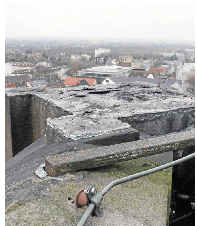
An dieser Stelle ist das Äquial an der Nord-West-Seite des Kirchturmes abgebrochen. Die Bauteile aus Sandstein (links im Text) sind weithin zu sehen.
