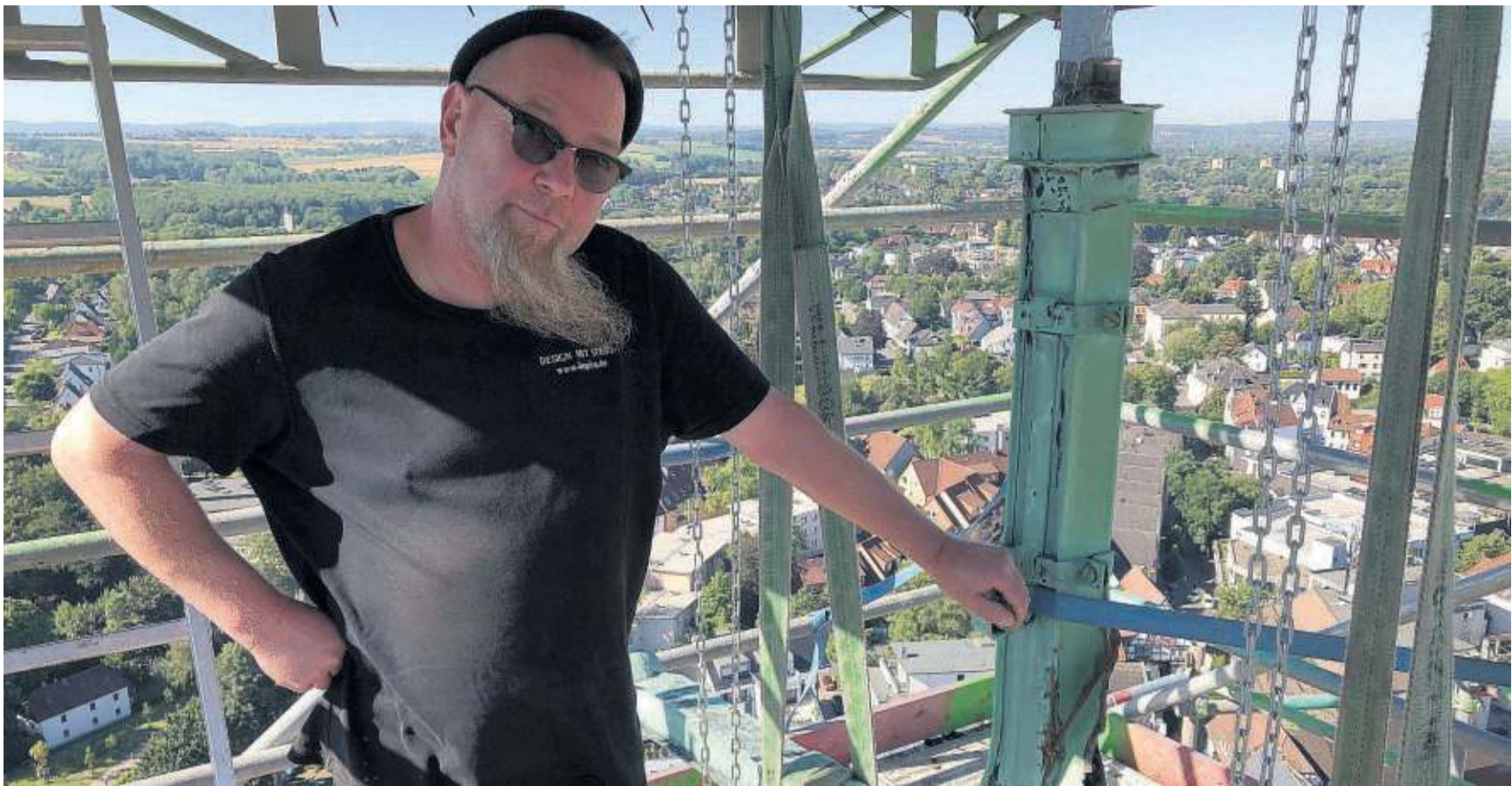
Kunstschmied Leo G. Pira hat seine Werkstatt in Alte Heide zurzeit mit einem luftigen Arbeitsplatz eingetauscht. In etwa 90 Metern Höhe arbeitet er das Kreuz auf dem Turm der Evangelischen Stadtkirche Unna auf.
