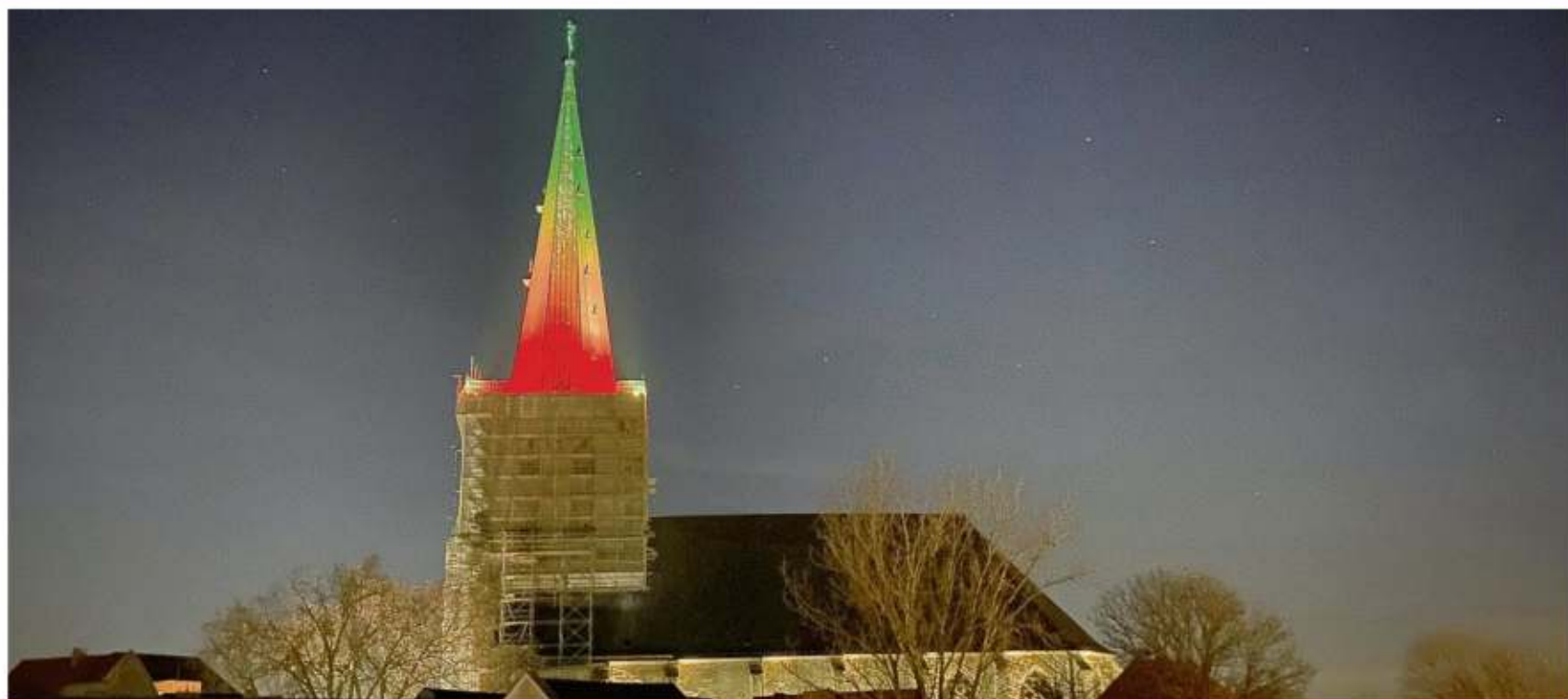
Der Kirchturm der Evangelischen Stadtkirche Unna leuchtet seit Ende November in einem farbenfrohen Spektrum. Er ist Teil der Lichtinstallationen von Wolfgang Flammersfeld in der Innenstadt. Die Lichttechnik muss jedoch für die Bauarbeiten am Turm in Kürze abgebaut werden. FOTOS ARCHIV
