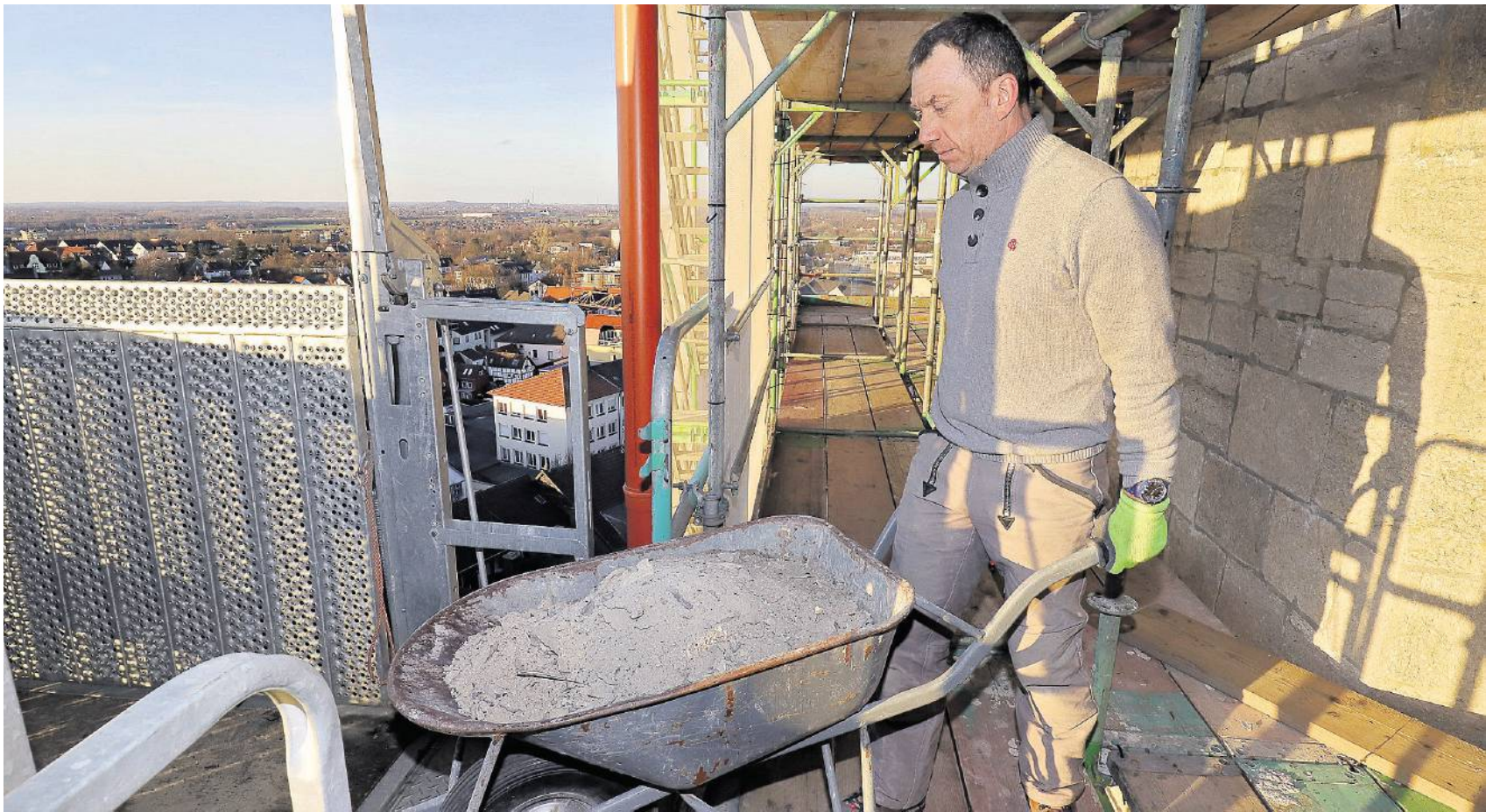
Luftiger Arbeitsplatz: Steinmetz und Polier Thomas Salinger bringt den Schutt aus dem Innern mit einer Schubkarre zum Aufzug.
