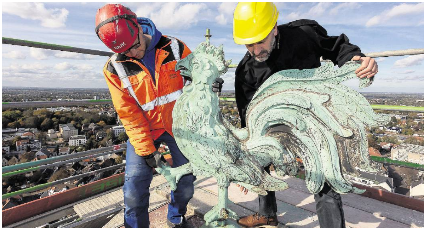
Gerüstbauer Michael Jesgarz (l.) und Dietrich Schneider vom Ev. Kirchenkreis begutachteten am Freitag mehr als 80 Meter über den Dächern von Unna den Stadtkirchhahn. Kurz darauf wurde er abgenommen.
