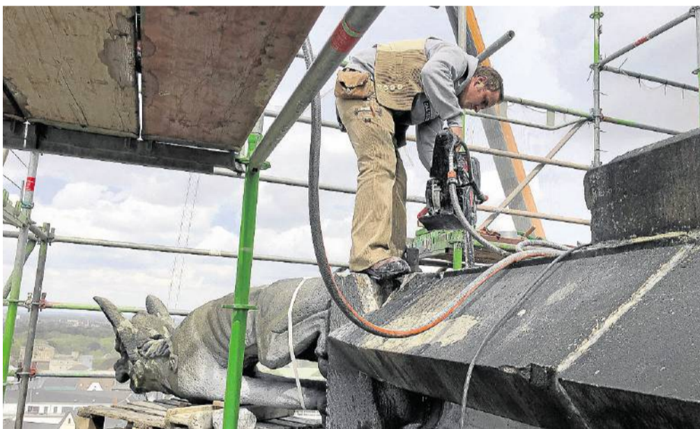
Vor allem mit einer wassergekühlten Spezialsäge trennten die Steinmetze den Wasserspeier von seinem Sockel. Das Baugerüst war zuvor schon umgebaut worden, um den Höllenhund notfalls abzufangen. FOTO RAULF
