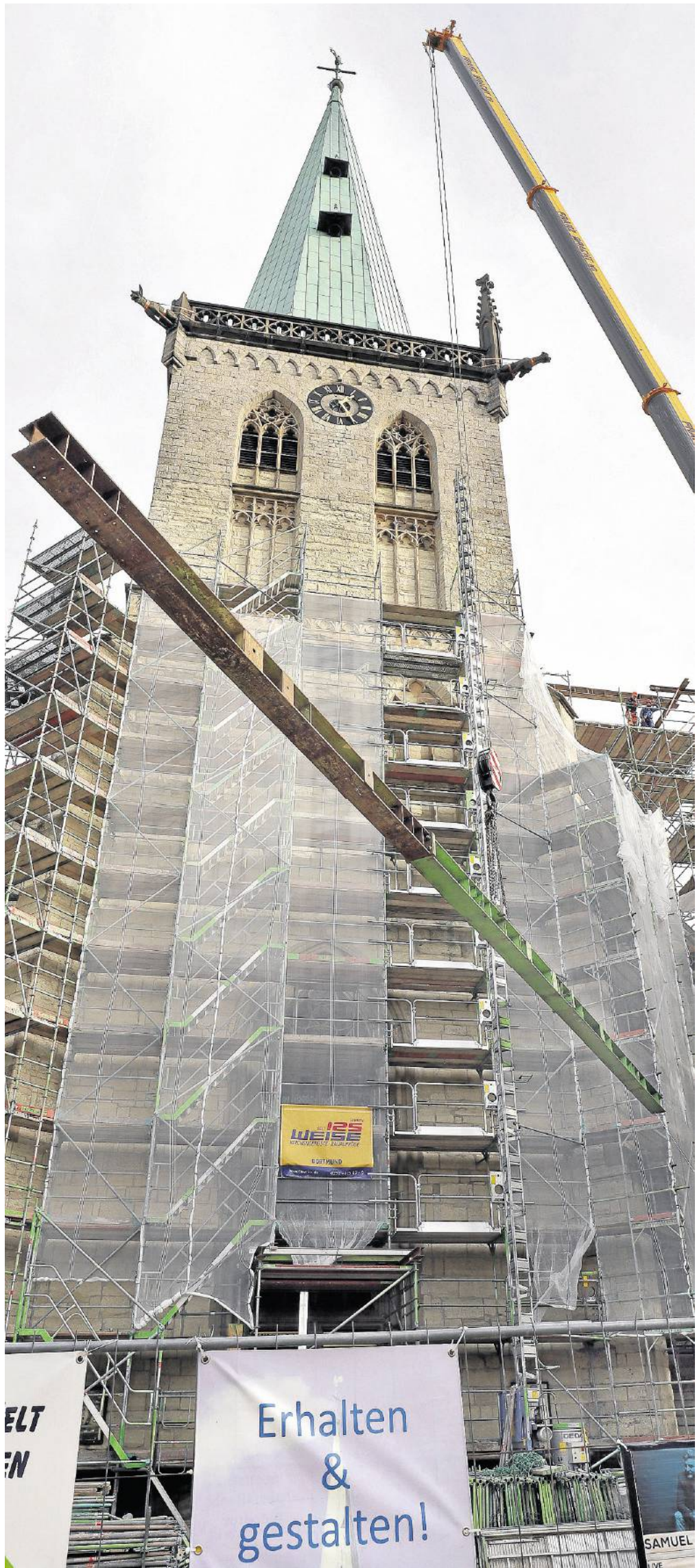
Mit großen Eisenträgern wurde eine Art „Zwischenboden“ des Gerüsts gebaut. Für den Transport nach oben war ein Spezialkran notwendig.
