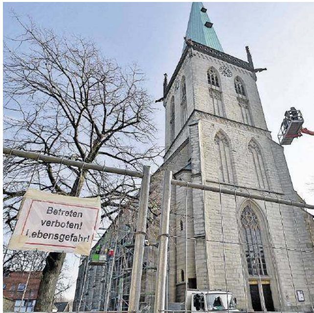
Die Reparatur und Sanierung der Stadtkirche wird Millionen kosten.
