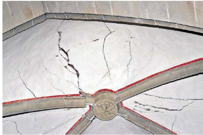
In dieses Gewölbe ist ein Teil der abgebrochenen Fiale gestürzt. Seitdem ist es instabil. FOTO: HENNES
