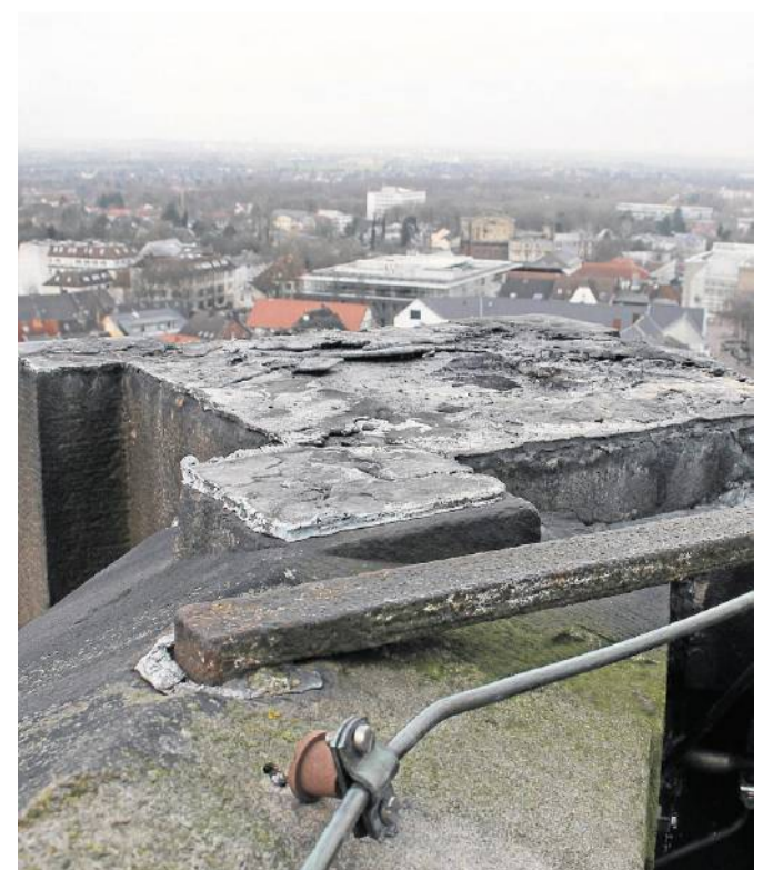
An dieser Stelle ist das Äquial an der Nord-West-Seite des Kirchturmes abgebrochen. Die Bauteile aus Sandstein (links im Text) sind weithin zu sehen.
